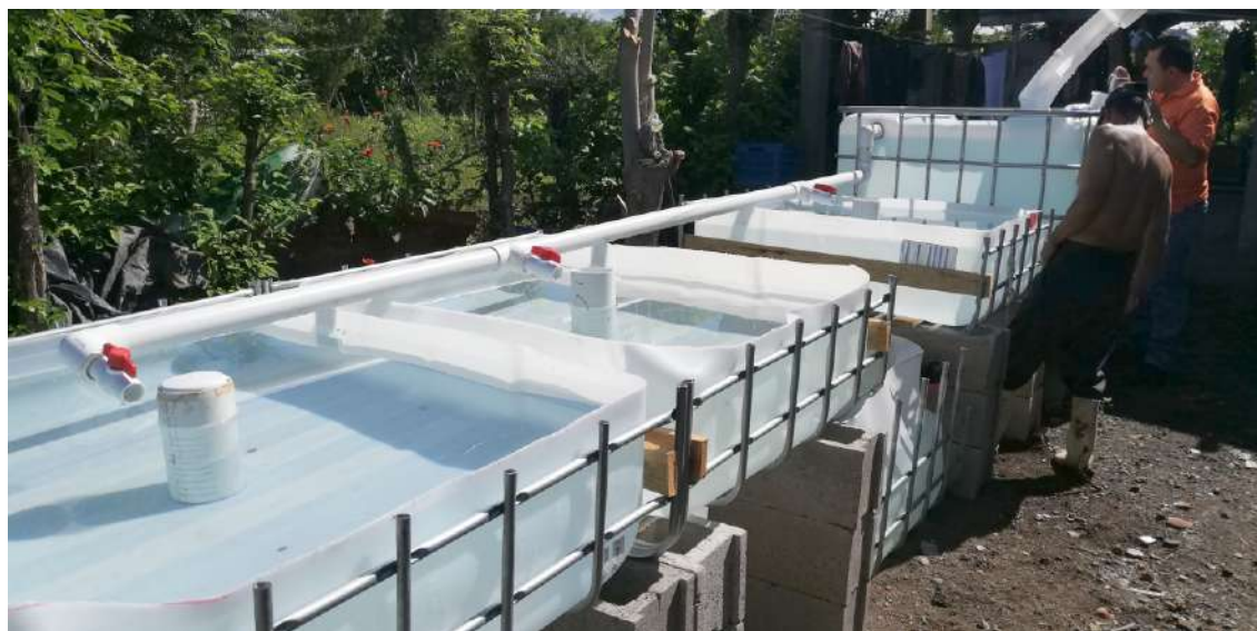
Todas las partes del Sistema de Acuaponía quedan interconectadas por tuberías de conducción del agua.
