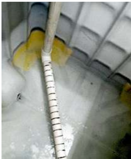
Forma de instalación de esta tubería filtro en el tanque de peces.
