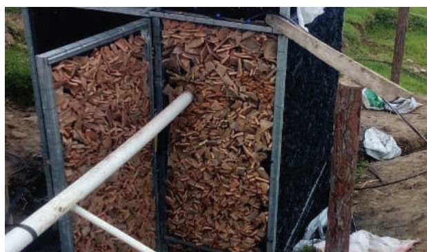
Imagen 5. Cámara de enfriamiento cero energía
