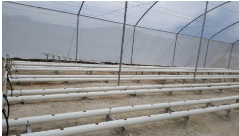
Imagen 3. Tuberías de 4" del sistema hidropónico
